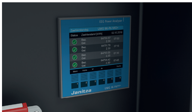
Das verbaute Janitza UMG 96-PA-MID+ Messsystem mit Farbdisplay.
